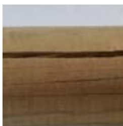
Cracks/Grietas/Fente/Risse/ Crepe/ Barsten/Fendas
